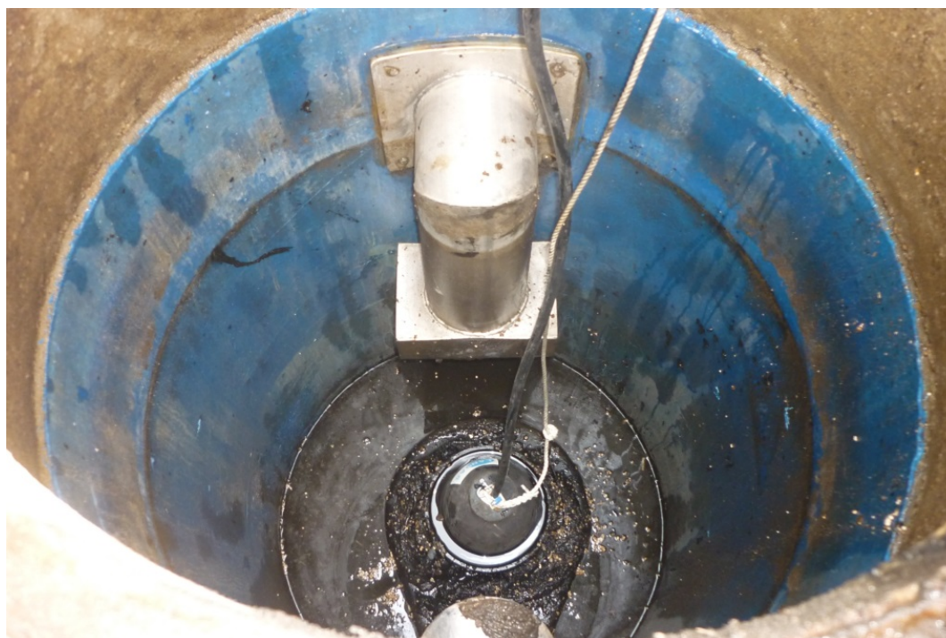
Foto: Afsluiter in afscheiderinstallatie.
