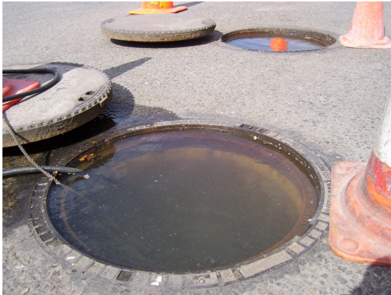
Foto: Hydrologische meting afscheidingsinstallatie
