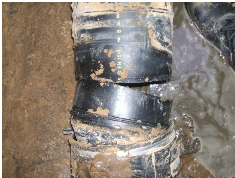
Foto: Lekkage/breuk in leidingwerk.
