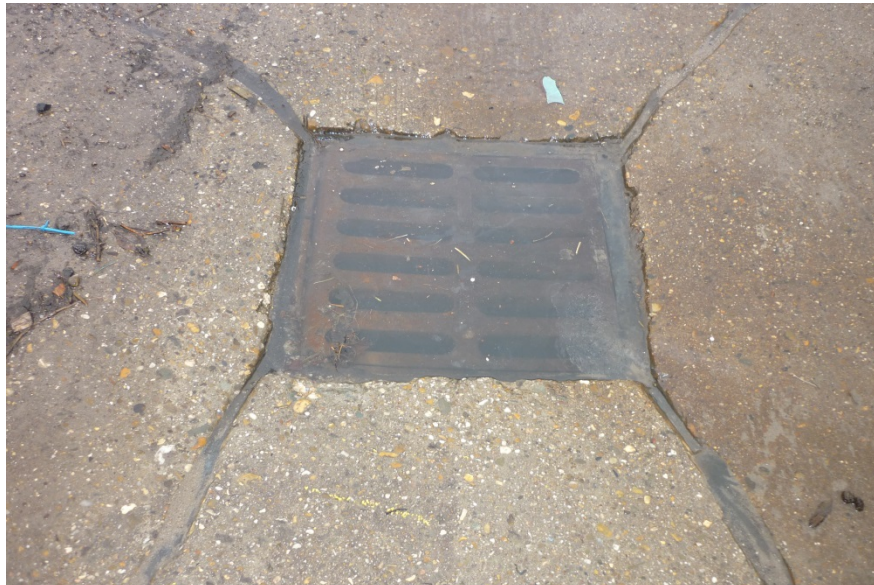
Foto: Ontvangpunt tot bovenzijde gevuld met water.
